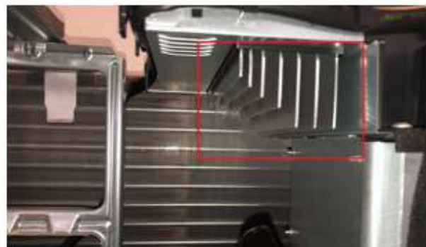
Sprawdź czystość radiatora falownika sprężarki:
